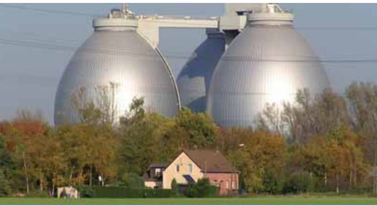
Serbatoi per la digestione anaerobica, impianto di trattamento delle acque reflue «Emschermündung» (Germania)
