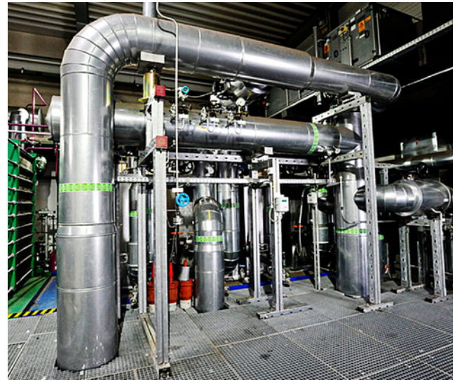
▲ Abbildung 13: Zentrale Heizanlage des Lebensmittelherstellers Develey am Produktionsstandort Unterhaching
