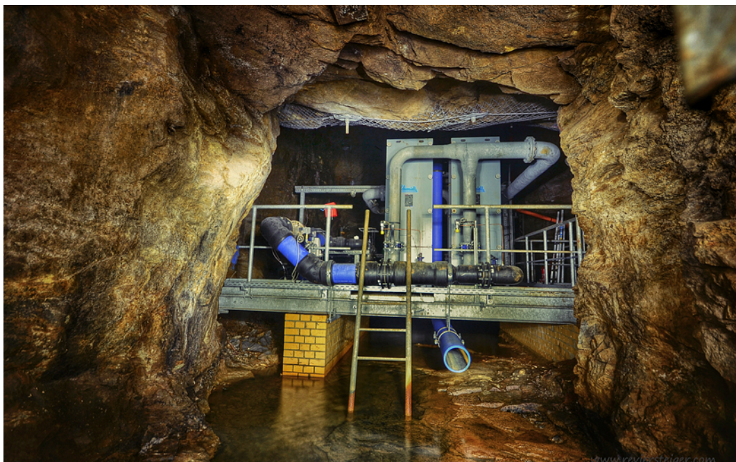
▲ Abbildung 15: Schachtfüllortstrecke des „Wismutschachts 302“ unter der Stadt Marienberg im sächsischen Erzgebirge. Seit 2007 versorgt ein Wärmepumpenkraftwerk in 107 Metern Tiefe die Region mit circa 10 Grad Celsius warmem Grubenwasser. Besonders das Freizeitbad Aqua Marin nutzt die Anlage im Sommer zur Kühlung.
