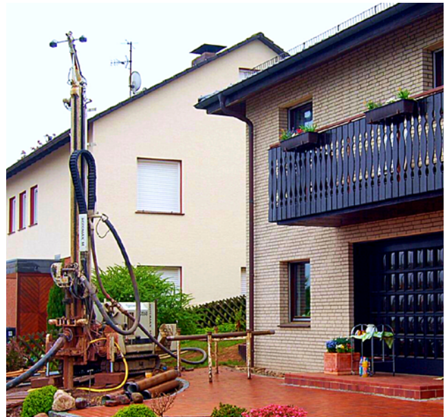
▲ Abbildung 8: Auch im Altbau kann Geothermie sinnvoll eingesetzt werden
